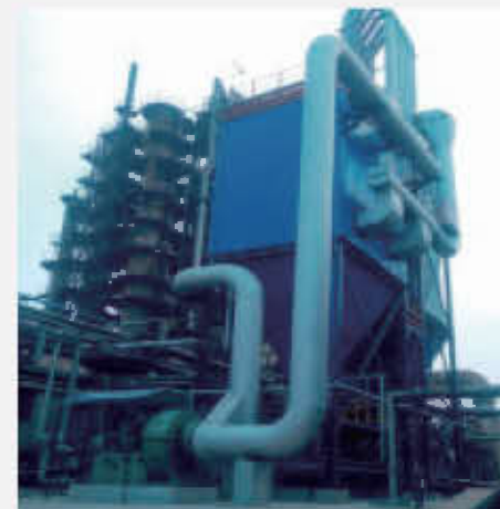
中化蓝星石油催化裂化再生烟气除尘项目
