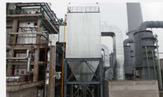
北京大兴 10x70W 锅炉集中供热工程
